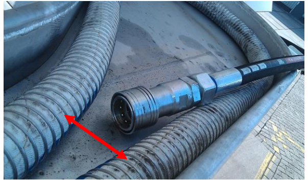
LNG unloading hose
